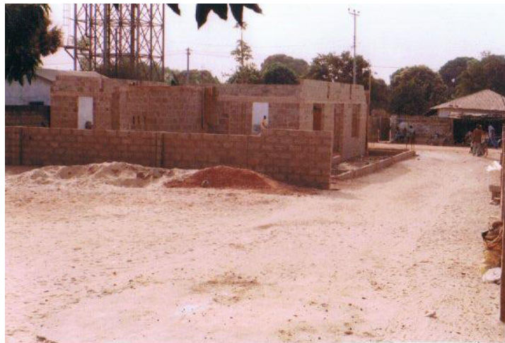
Die Mauer nimmt Formen an! Im Hintergrund sieht man den Rohbau einer Moschee, die nichts mit dem Schulprojekt zu tun hat.
